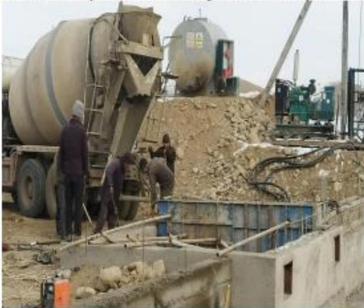
Фото 7, 8 : В производственной площадке рабочий персонал работает без спец.одежда/ Photos 7, 8 : At the production site, the working staff works without special clothing
