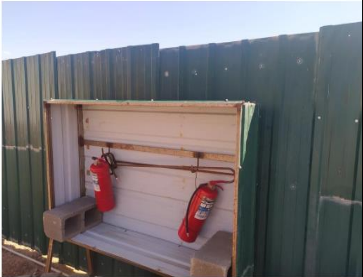
Фото 9: Противопожарные щиты не укомплектованы
