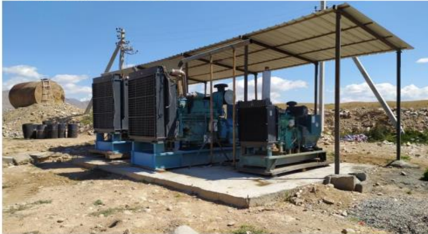
Фото 8. Генератор на производственной базе не огражден
